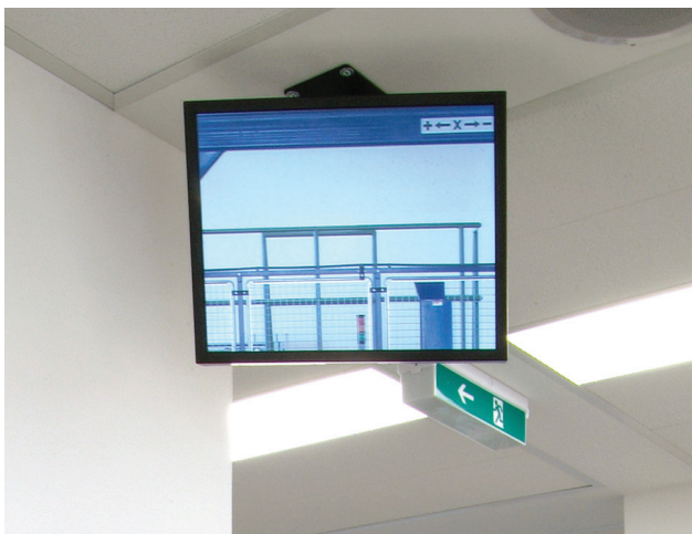
Installationsansicht: Monitor 1, LCD-Bildschirm an Decke montiert.
