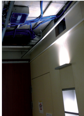
Elektrische Anschlüsse Nische / Leuchten / Wandöffnung
